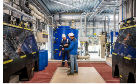
Waterbedrijf Groningen, installatie voor opgesloten grondwater. Foto: Giert Job Seebregt
