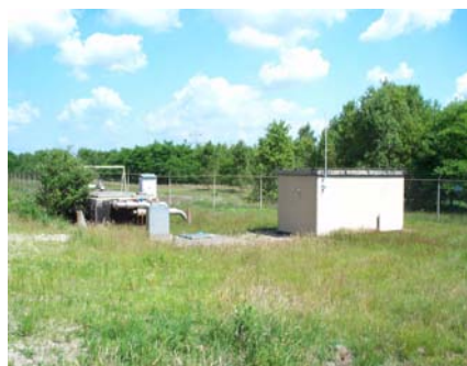
Pompstation naar Waterzuivering
